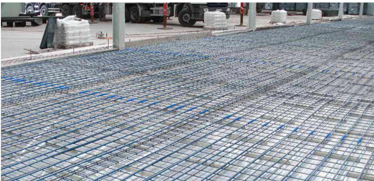
Obr. 4. Inštalácia podlahového kúrenia v sklade pomocou rúr bluePERT a systému KAN-therm NET.
